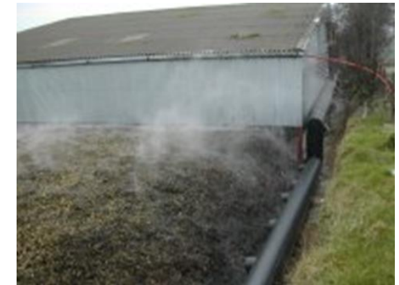
Abluftreinigung, Bildquelle: Compost Systems GmbH
